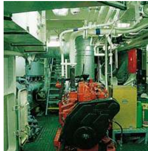
la sala de máquinas engine room
