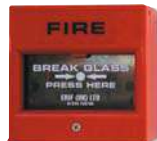
la alarma contra incendios fire alarm
